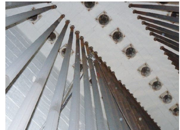
Contrôle des tubes de reformage avec LEO-Scan
